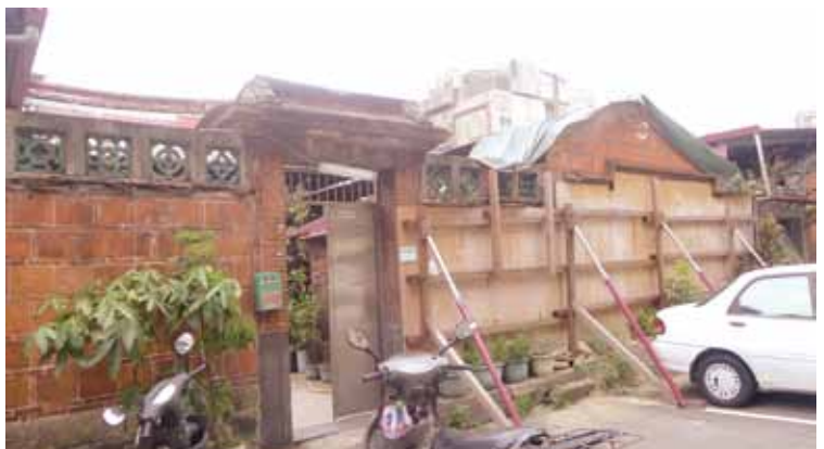
正向大門牆體，因大雨滲水有崩塌之慮，由於經費預算的受限，僅能以模板貼牆外支撐補強，作暫時性搶修。
