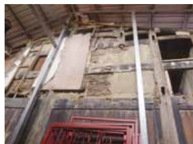
目前第一進西側梢間已塌陷，屋頂滲漏嚴重，暫時搭設鋼柵架遮蔽。屋內木構材危害以白蟻蛀蝕及腐朽劣化最為嚴重。
