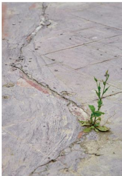
地層下陷引起水泥地龜裂。
